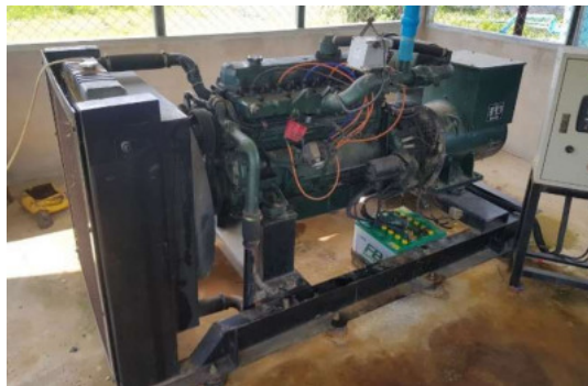
ภาพที่ 4 เครื่องปั่นไฟขนาด 50 kW 60 KVA
